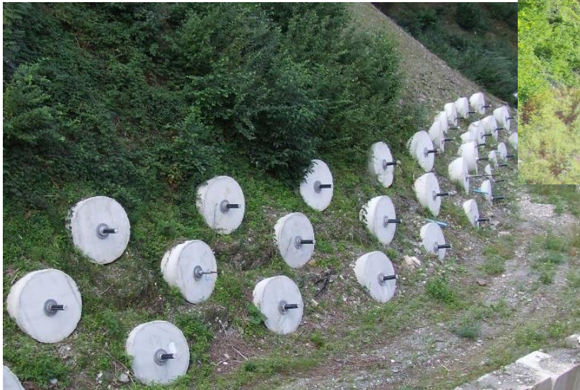
Gisbenti landslide (Valli del Pasubio, VI)
